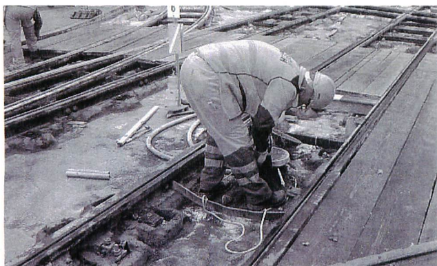
■写真—15 トラム電停付近でトラム向けの情報発信装置を地中に取り付けている様子 [Bellevue付近にて撮影]
